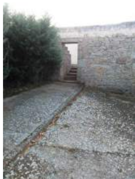
Eliminación por mal estado de la puerta de acceso al frontón tradicional
